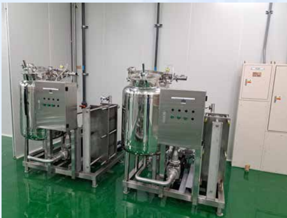
夾套用熱水設備 製程用熱水設備
